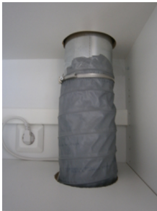
Bild 5, Ventilationsslangens infästning i ventilationsröret.
